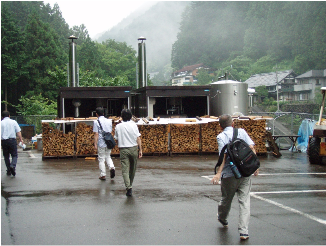
写真1 数馬の湯のボイラーと薪。
