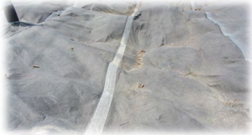
草木類沈下による凸凹
