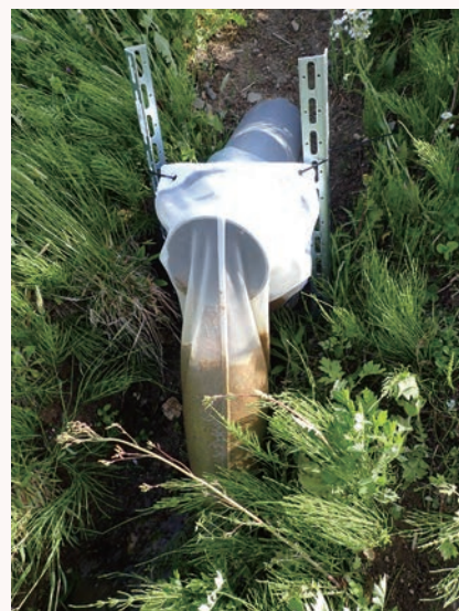
写真2 降雨後にネットに捕捉された土砂
