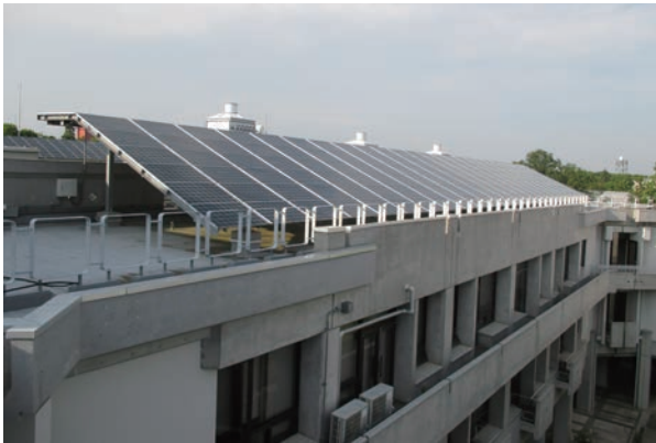
太陽光発電設備（研究本館屋上）
