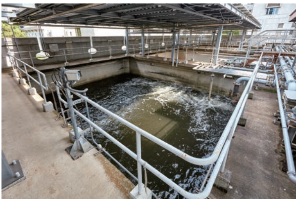
実験廃水処理施設（貯留槽：500 t × 3槽）
