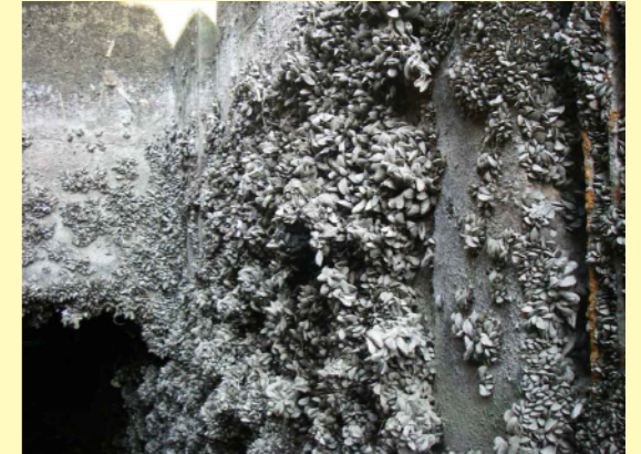
コンクリート壁面で大量発生したカワヒバリガイ
