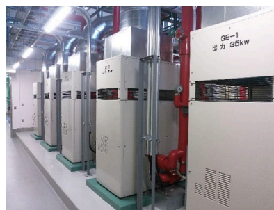
(b) LNG Cogeneration
