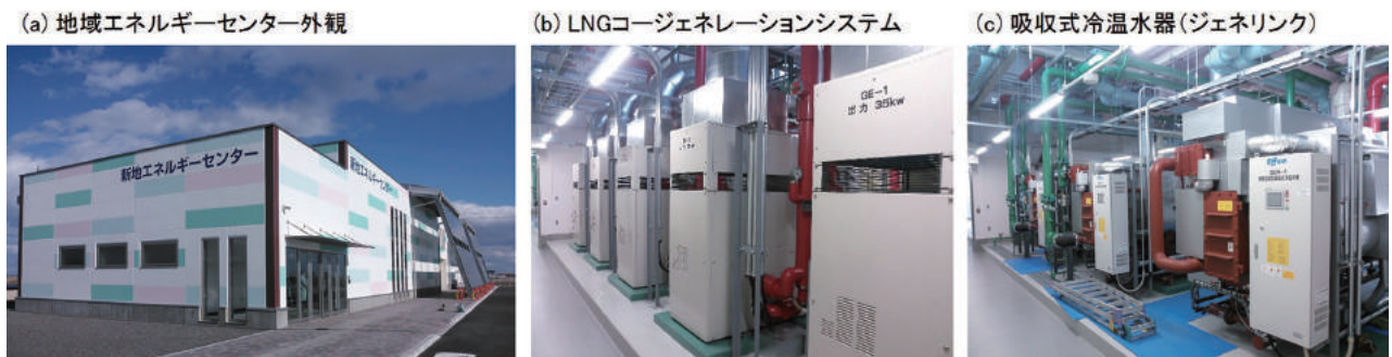
図 3 新地町の地域エネルギーセンターの建物と主要設備
